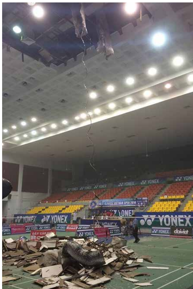
Hình 2: Sập trần nhà thi đấu Phan Đình Phùng-Tp. Hồ Chí Minh
