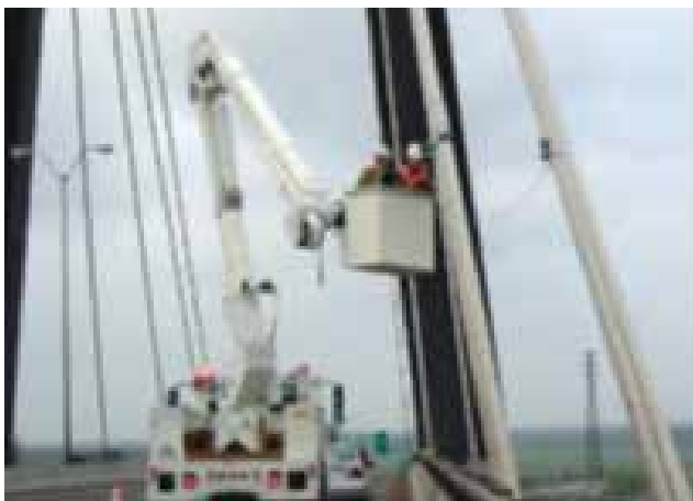
Hình 1. Đo dao động cầu dây văng sử dụng đầu đo điện tử truyền thống.
